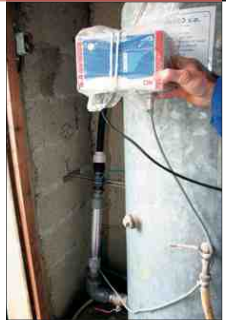
L'installation en sortie de cuve , avec le tube et le boîtier
