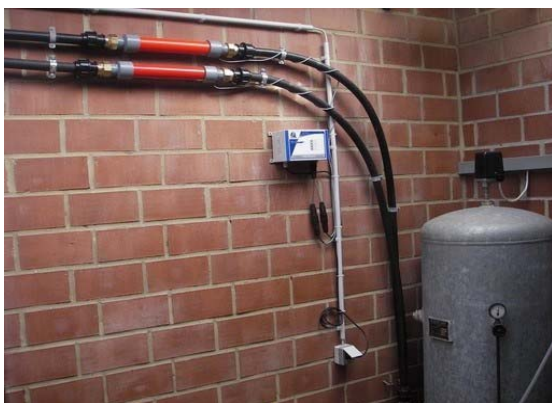
Installation dans un élevage à Cloppenburg (Allemagne) (Mars 2007)
